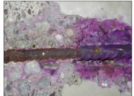
Abb. 1: Prüfung der Carbonatisierung mit Phenolphthalein. Die Korrosion im carbonatisierten Bereich (farblos) ist deutlich erkennbar
